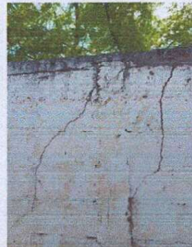
Foto 2: REPARACION Y REFUERZO MURO PERIMETRAL EN MAL ESTADO
