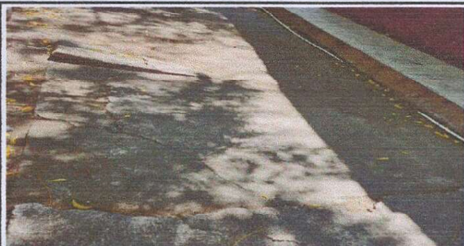
Foto 3: REPARACIÓN DE LOSA DE PATIO EN MAL ESTADO, CON UN ESPESOR DE 8CM.
