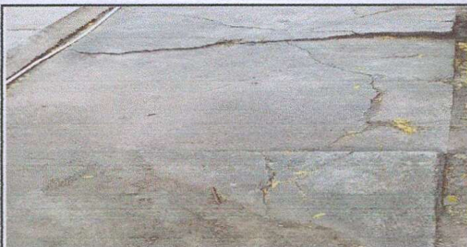
Foto 6: REPARACIÓN DE LOSA DE PATIO EN MAL ESTADO.
